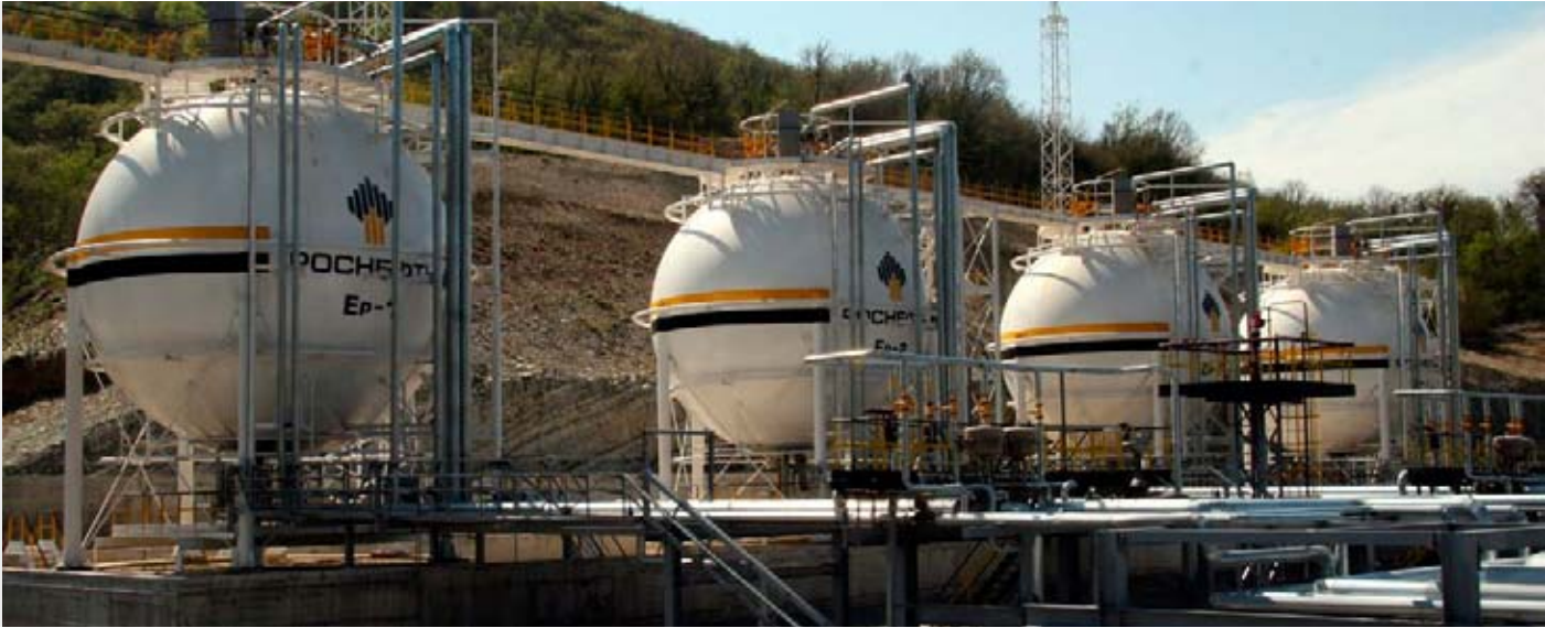
Резервуары для хранения сжиженного газа Туапсинского НПЗ
